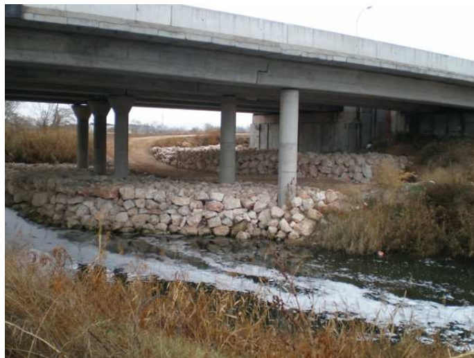
Foto 19. Ejemplo claro de acumulación de impactos en el puente de la carretera M-203, junto a la EDAR Oeste de Alcalá. Se observa la escollera, sin restauración alguna, y las espumas de la propia EDAR.
